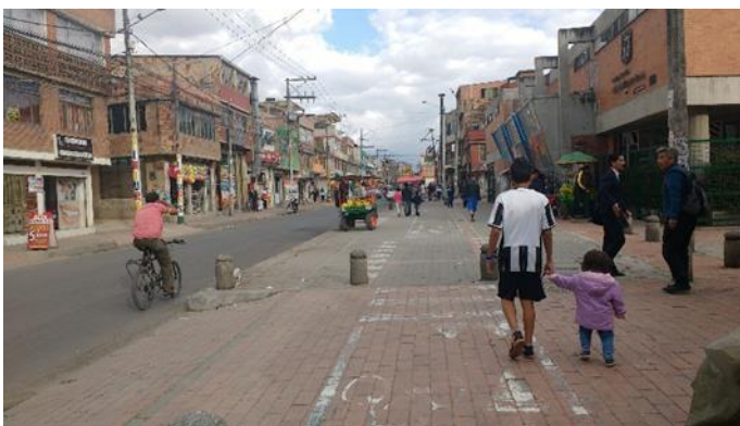
Fotografía 6. Ciclorruta entrada IED Orlando Higuita Rojas con demarcación borrada
